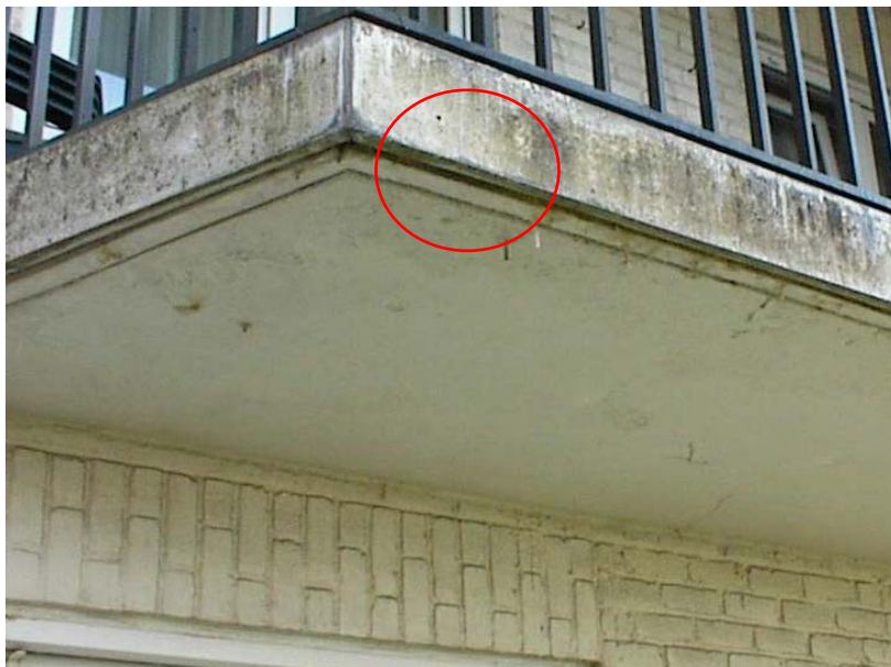
Figuur 4: Stalactietvorming onderaan een balkon
