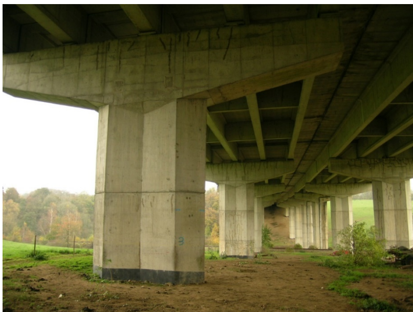
Figuur 3: Een betonconstructie, getroffen door de alkali-silicareactie
