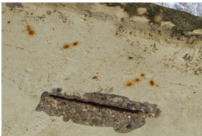
Figuur 10: Roestsporen aan het betonoppervlak
